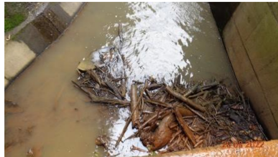
Figura 39 – Pouco material acumulado na saída descarga de fundo (Insp. 2022)
