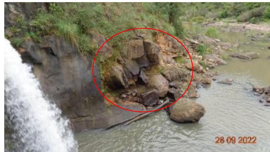
Figura 37 – Erosão no talude esquerda sem mudanças (Insp. 2022)
