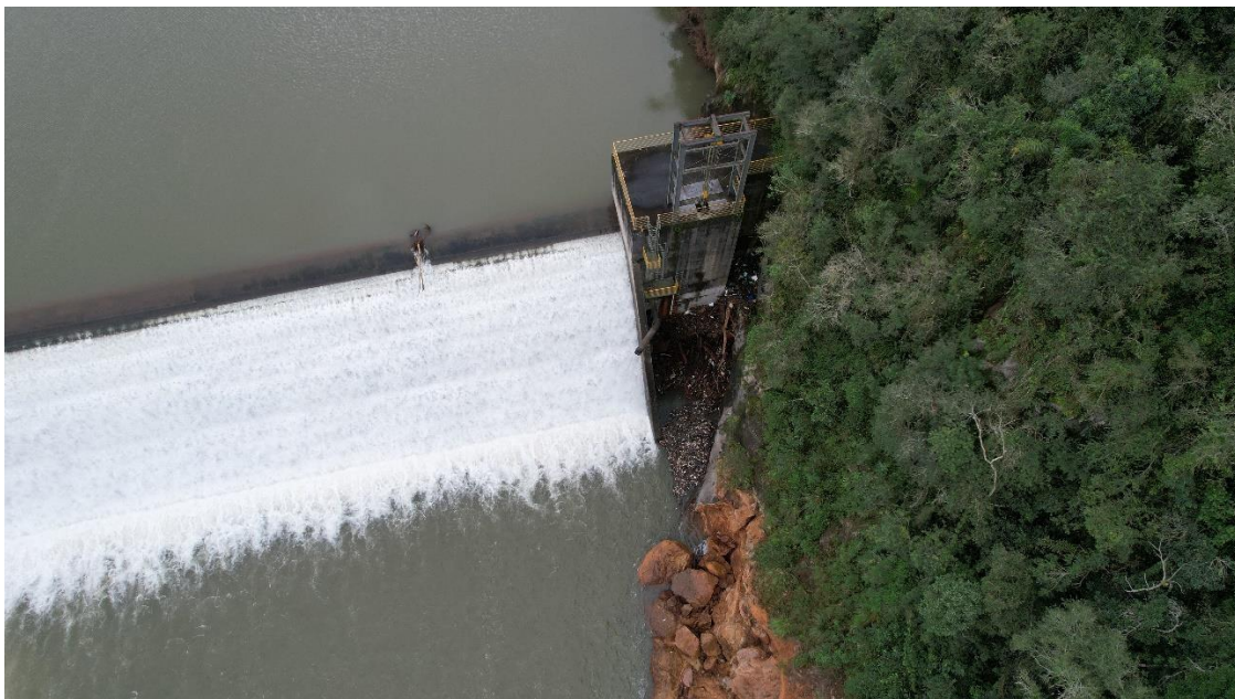
Figura 27 – Grande acúmulo de material a jusante da barragem
