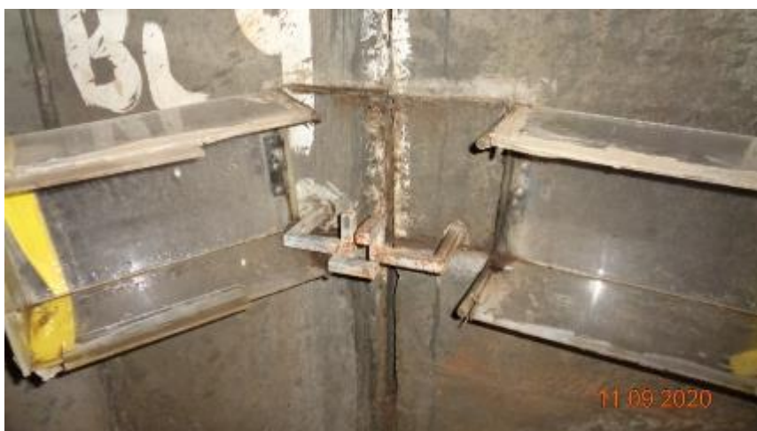
Figura 16 – Medidor Triortogonal de Junta – MT, melhorar a proteção contra ferrugem (Insp. 2020)
