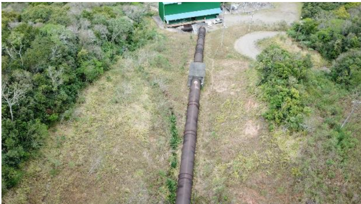
Figura 41 – Conduto Forçado (ISR 2022)
