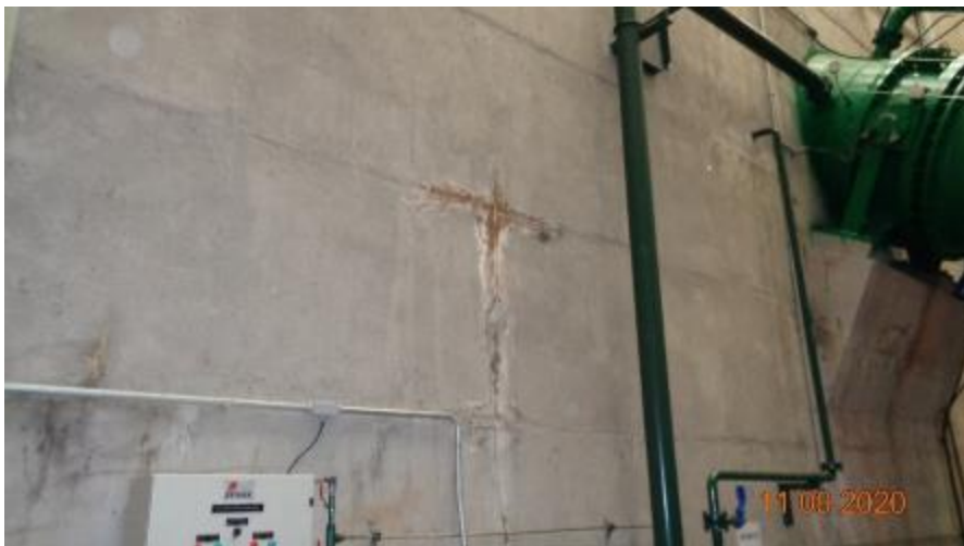
Figura 101 – Ponto de infiltração inativa (Insp. 2020)
