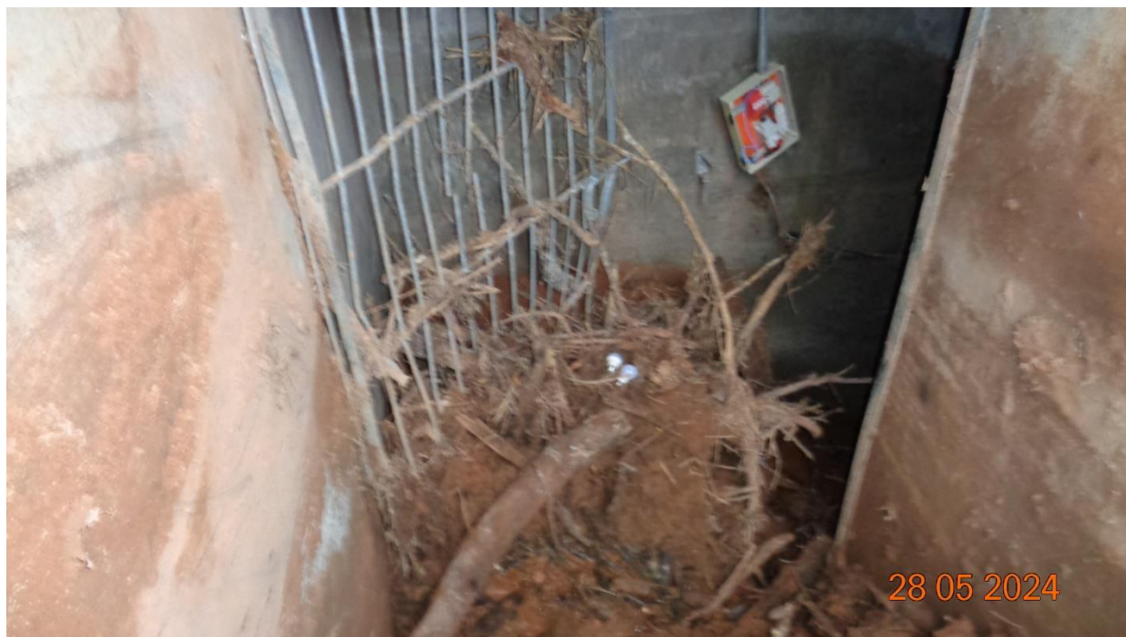
Figura 15 – Entrada da galeria obstruída
