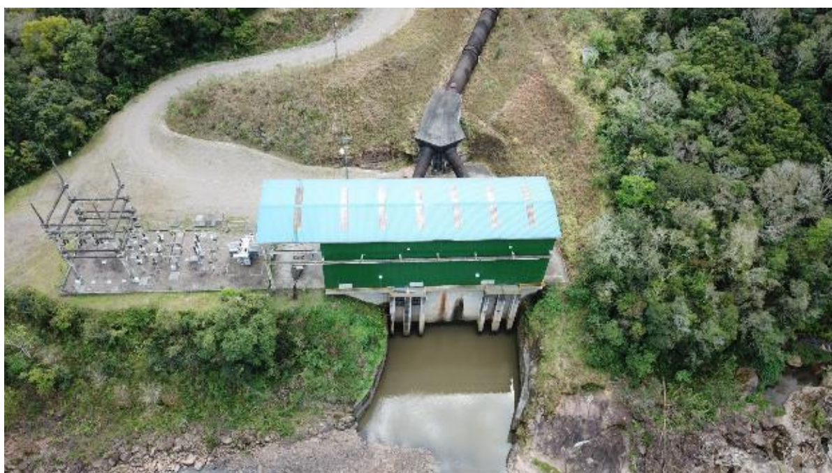
Figura 44 – Pátio da Casa de Força e subestação (ISR 2022)
