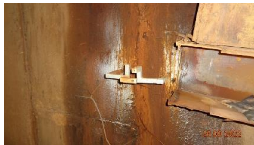
Figura 17 – Medidor Triortogonal de Junta – MT, nova pintura e controle da corrosão (Insp. 2022)
