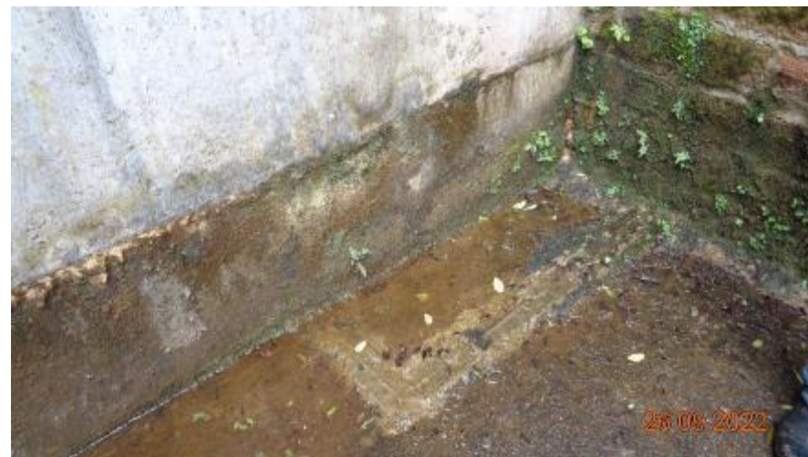
Figura 41 – Não existe mais percolação talude, após injeções (Insp. 2022)
