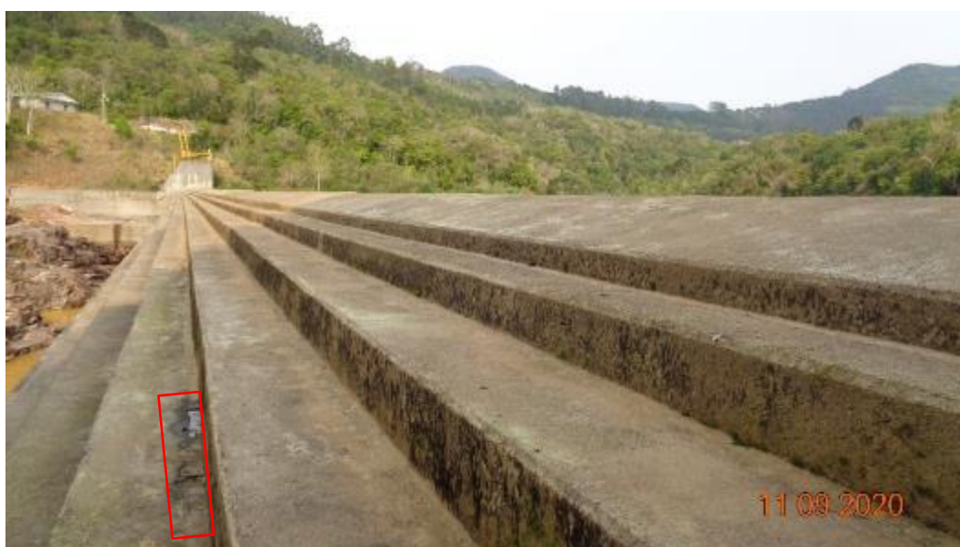
Figura 55 – Bicheiras/Cavitação nos degraus
