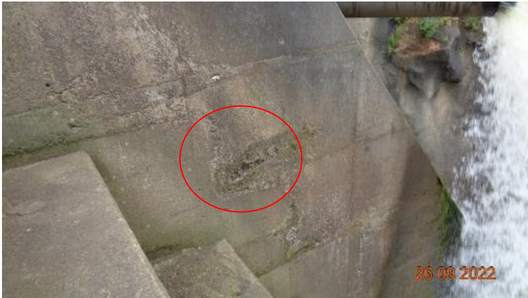
Figura 56 – Armadura exposta e bicheira, lateral esquerda
