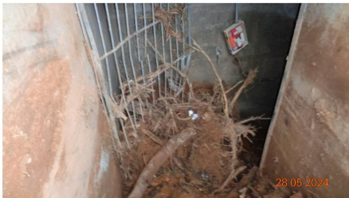
Figura 15 – Entrada da galeria obstruída
