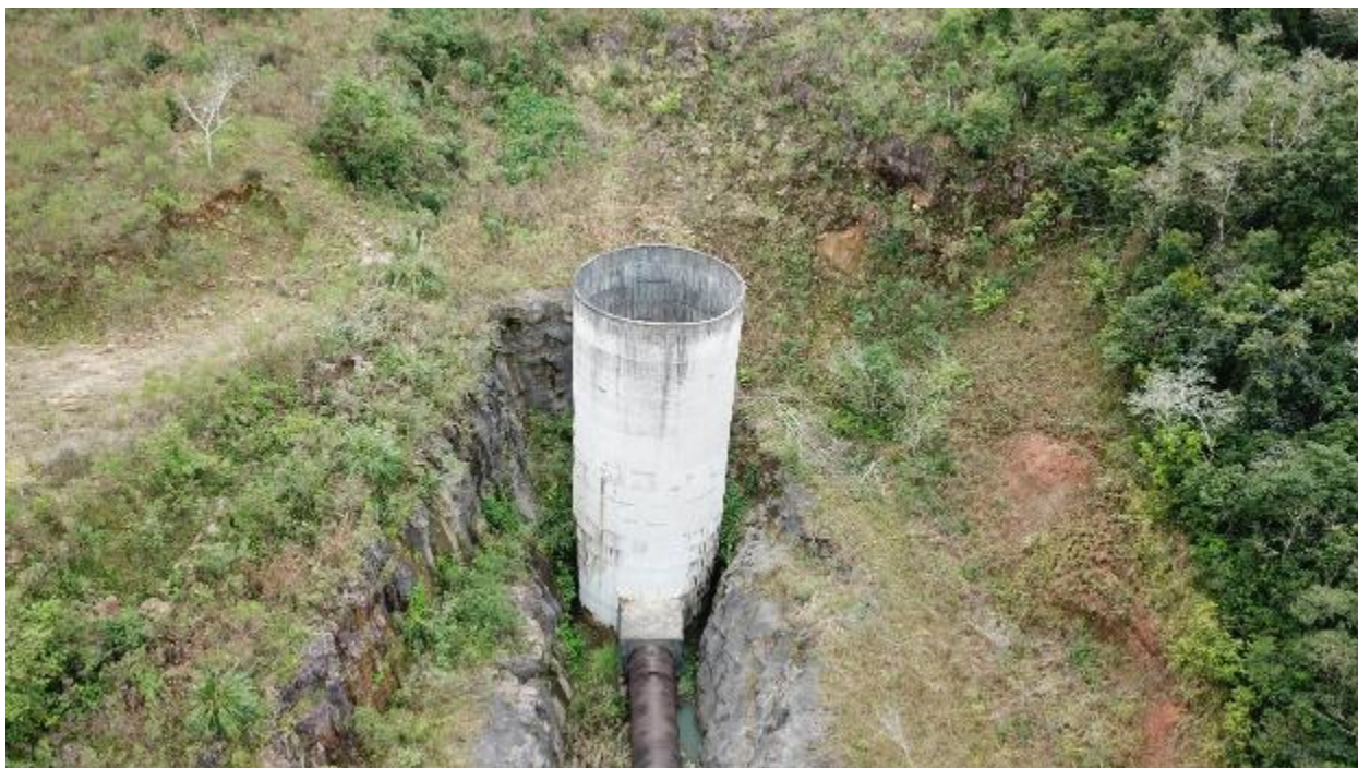
Figura 39 – Vista geral a Chaminé de Equilíbrio (ISR 2022)
