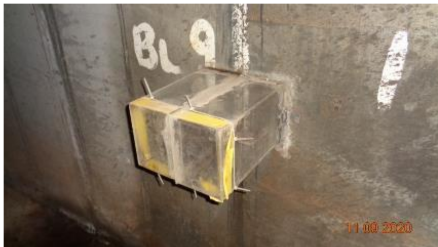
Figura 14 – Proteção e falta de identificação Medidor Triortogonal de Junta – MT (Insp. 2020)
