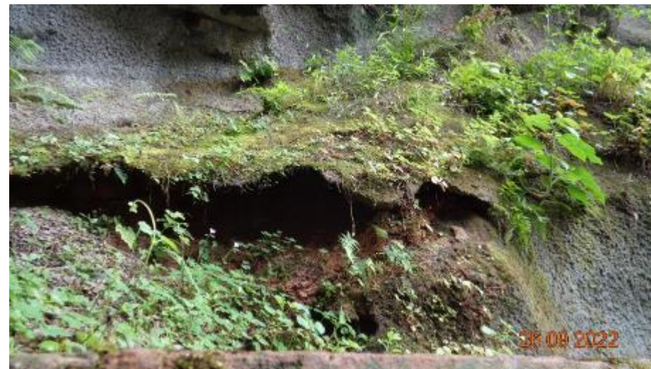
Figura 43 – Erosão pé do concreto projetado, sem grandes alterações (Insp. 2022)
