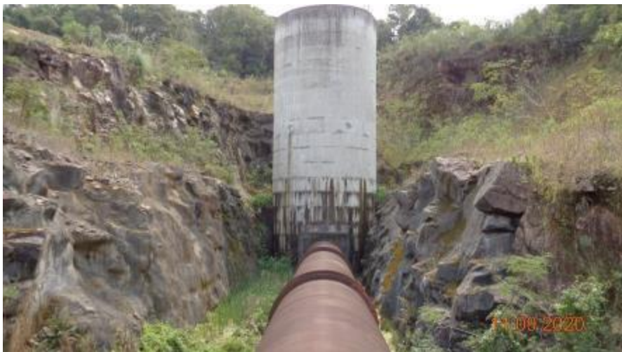
Figura 73 – Infiltrações concreto da Chaminé de Equilíbrio (Insp. 2020)
