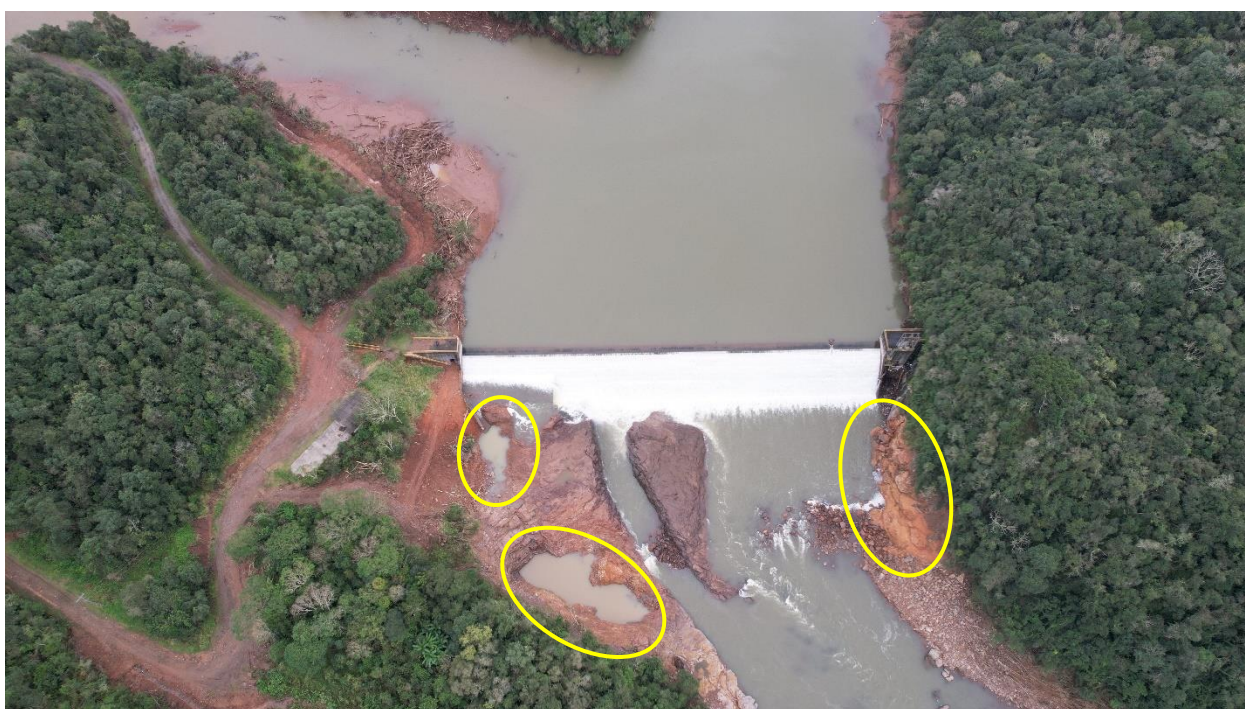
Figura 30 – Vista geral do Vertedouro (ISR 2024) destaque para as erosões
