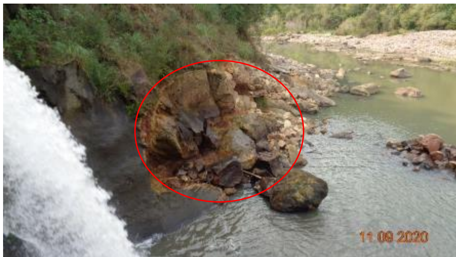
Figura 36 – Erosão no talude esquerda devido últimas enchentes (Insp. 2020)
