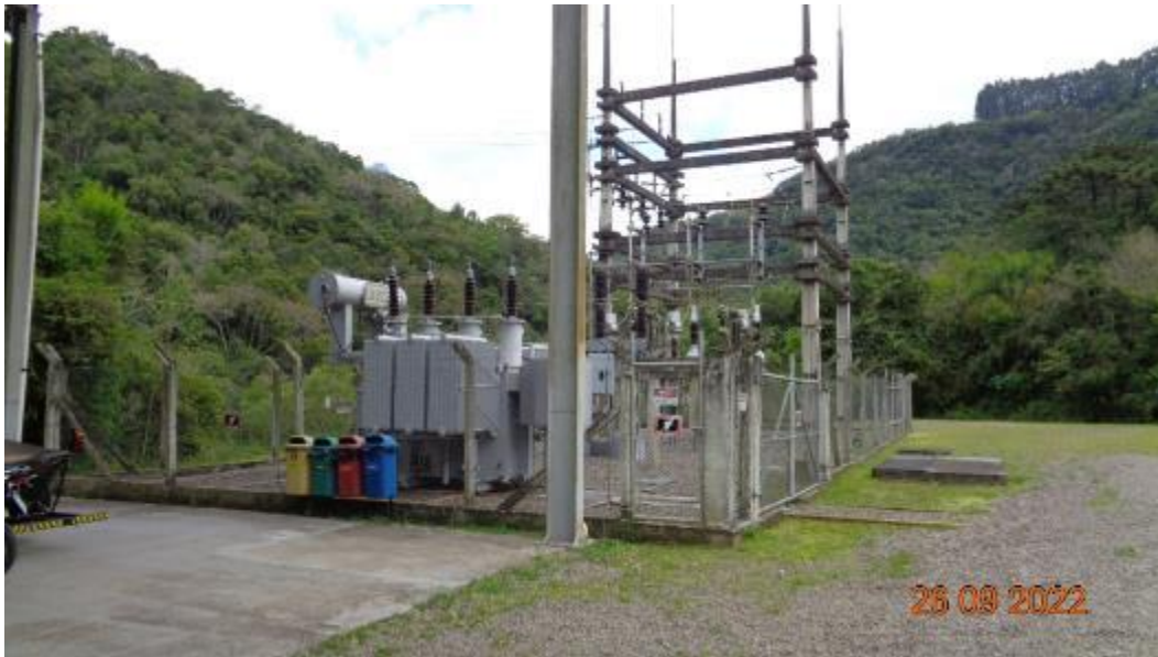
Figura 91 – Subestação na direita da casa de força
