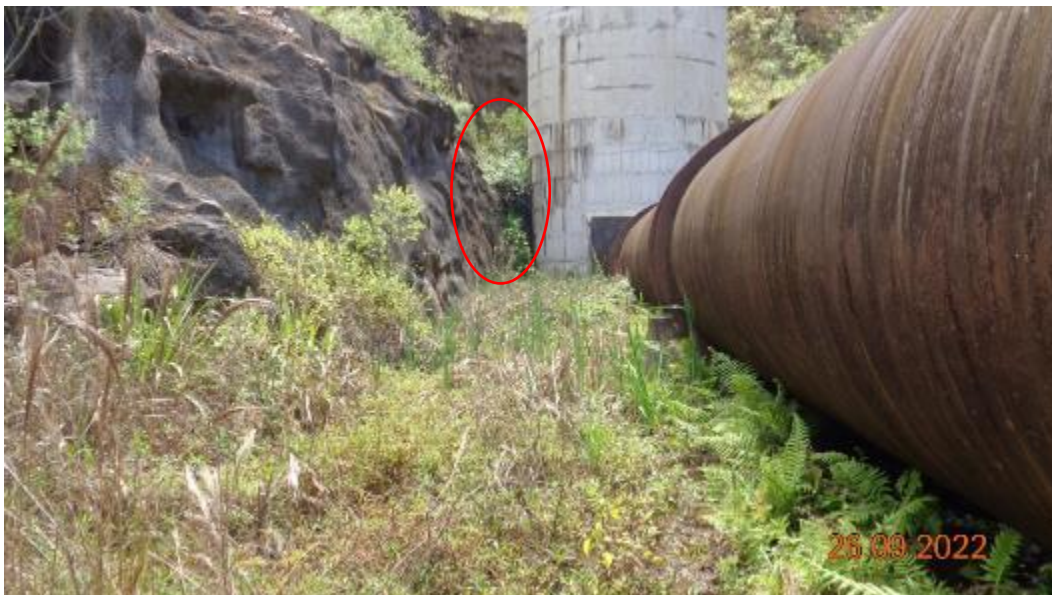
Figura 83 – Região percolação – lateral direita da chaminé
