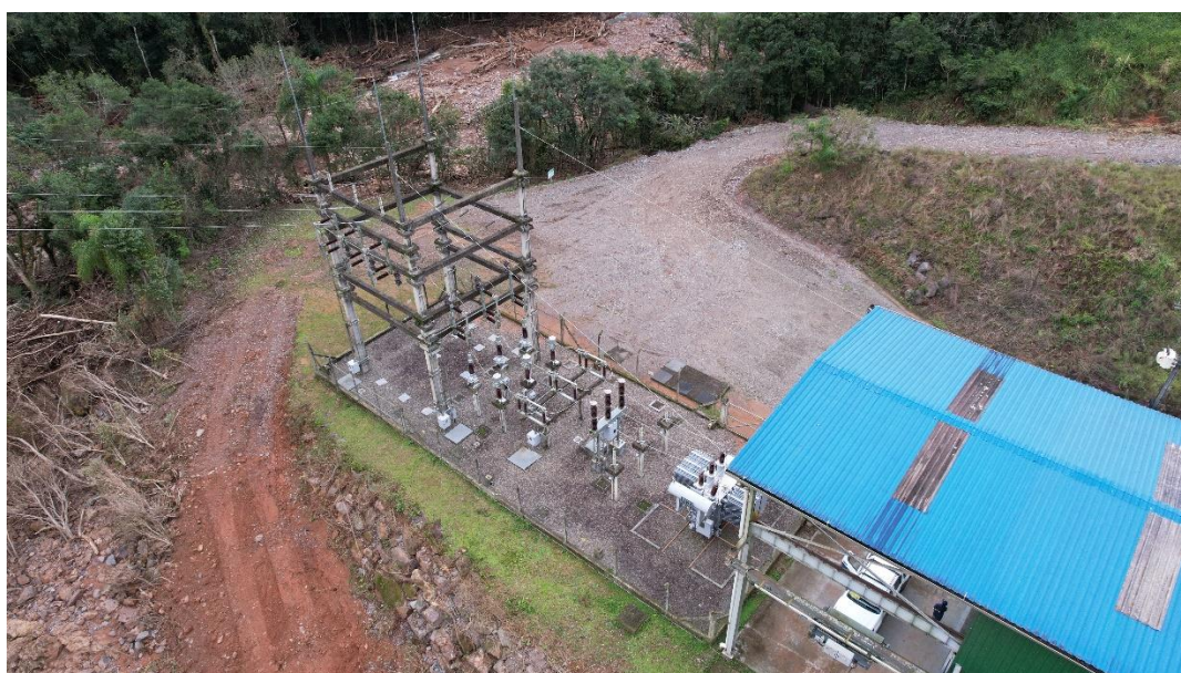
Figura 47 – Subestação na direita da casa de força em boas condições
