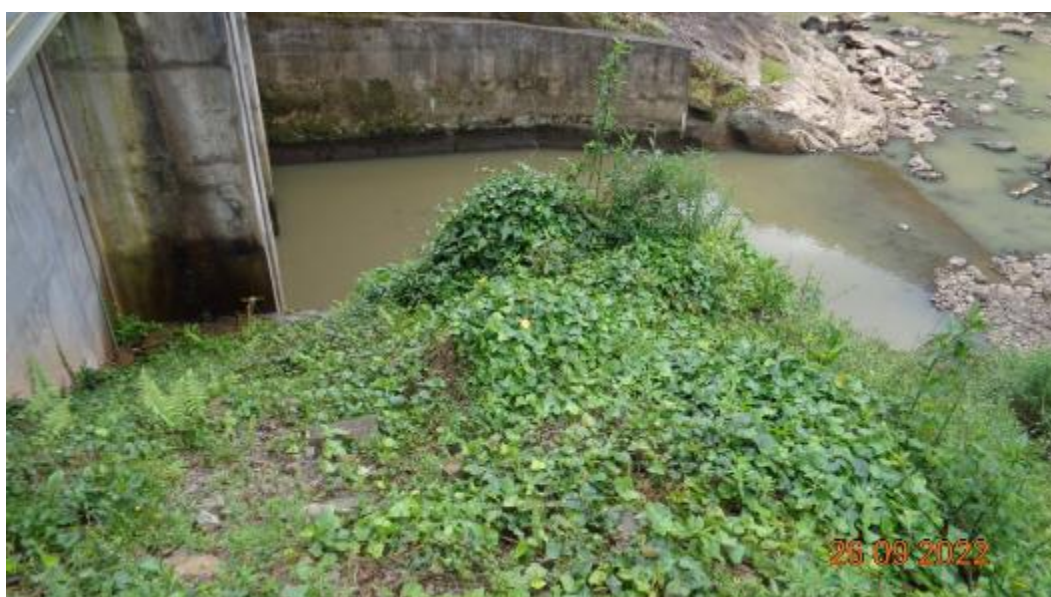
Figura 90 – Necessidade de limpeza da vegetação de maior porte (Insp. 2022)
