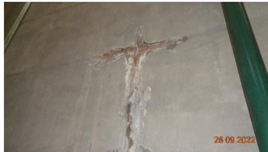
Figura 102 – Ponto de infiltração inativa (Insp. 2022)
