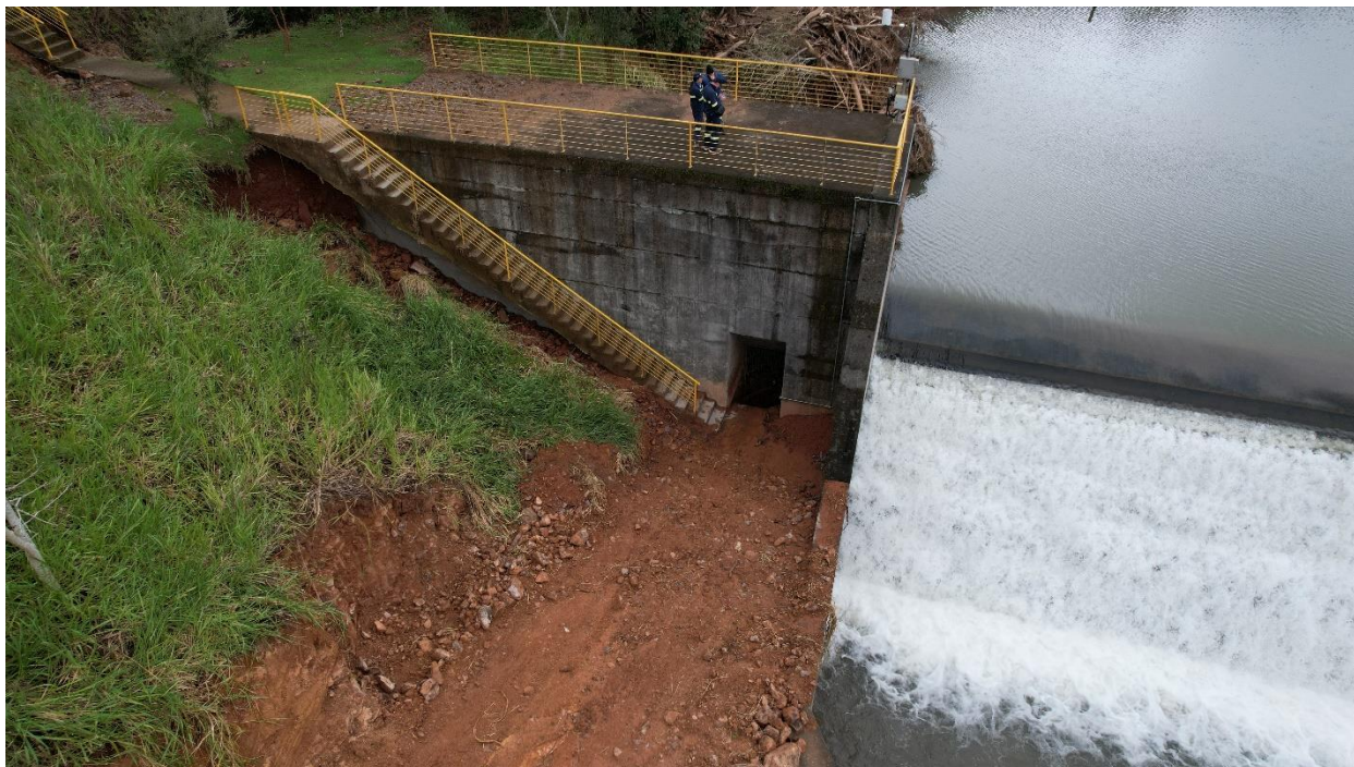
Figura 14 – Acesso para a galeria de drenagem obstruído
