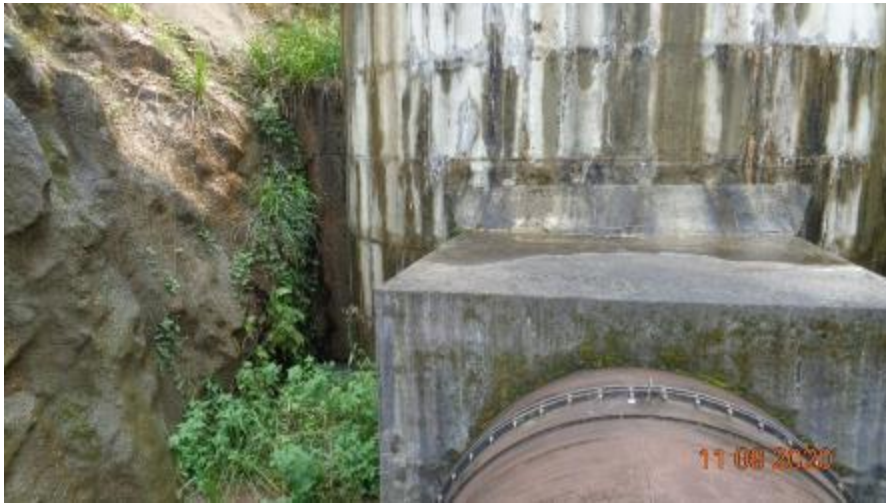
Figura 75 – Detalhe das Infiltrações concreto da Chaminé de Equilíbrio (Insp. 2020)
