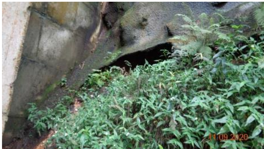
Figura 42 – Erosão pé do concreto projetado (Insp. 2020)
