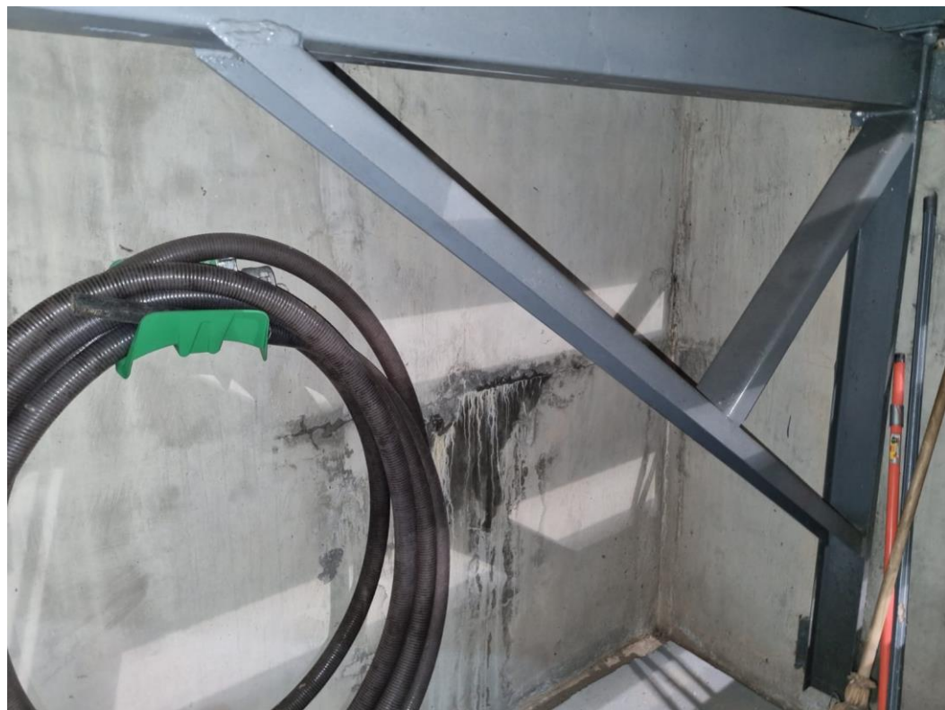
Figura 3 – Ponto de infiltração parede
