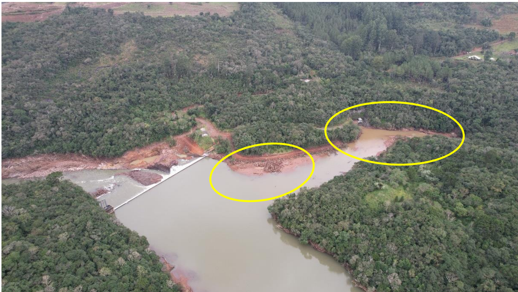
Figura 36 – Vista geral da região da tomada de água com muito material depositado
