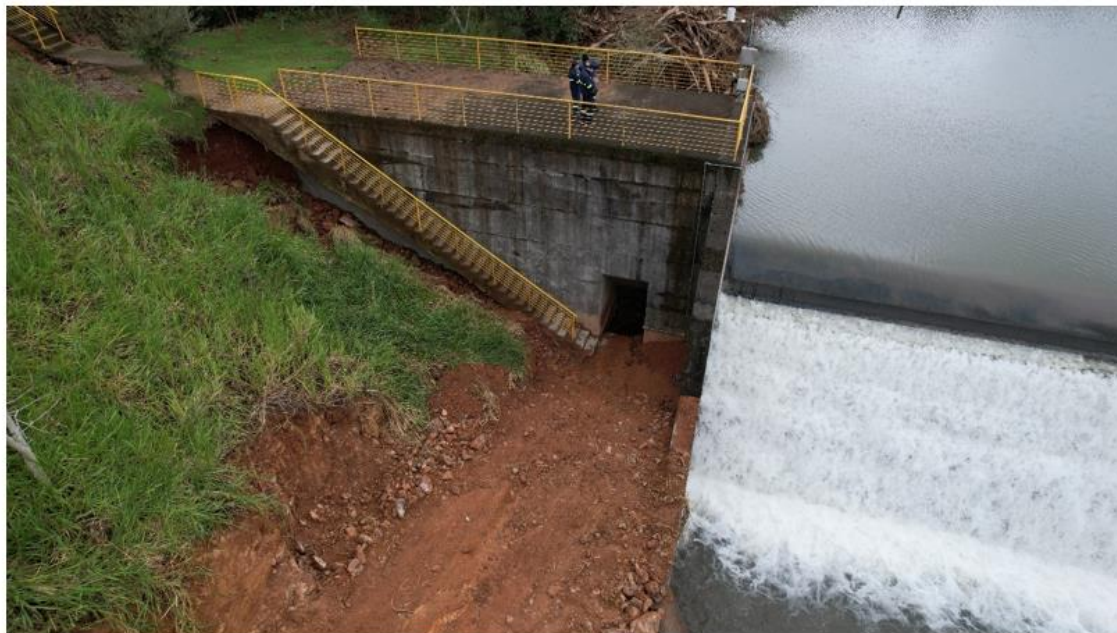
Figura 23 – Estrutura de concreto em bom estado e erosão na escada de acesso
