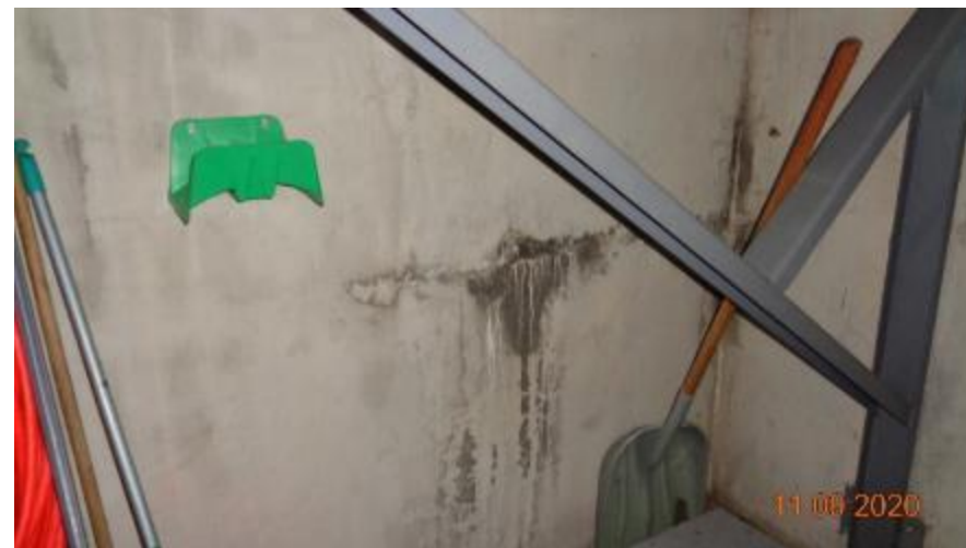
Figura 100 – Ponto de infiltração parede (Insp. 2020)
