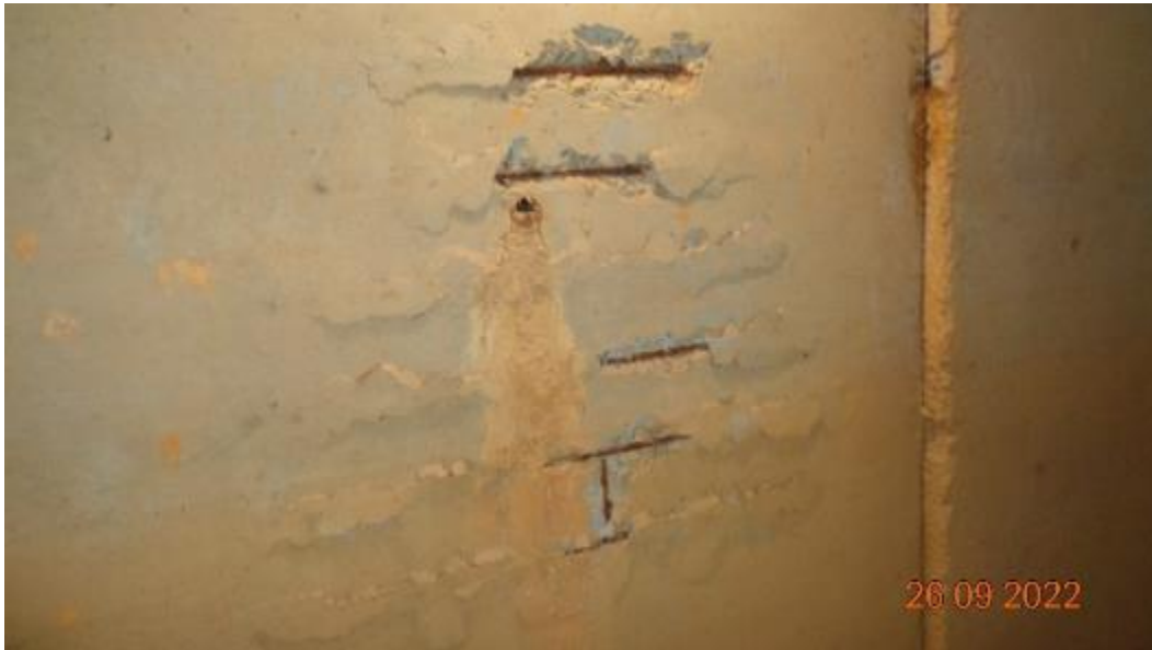
Figura 62 – Armadura exposta do pré-moldado, esta é só passar antiferrugem e fechar bicheira no concreto
