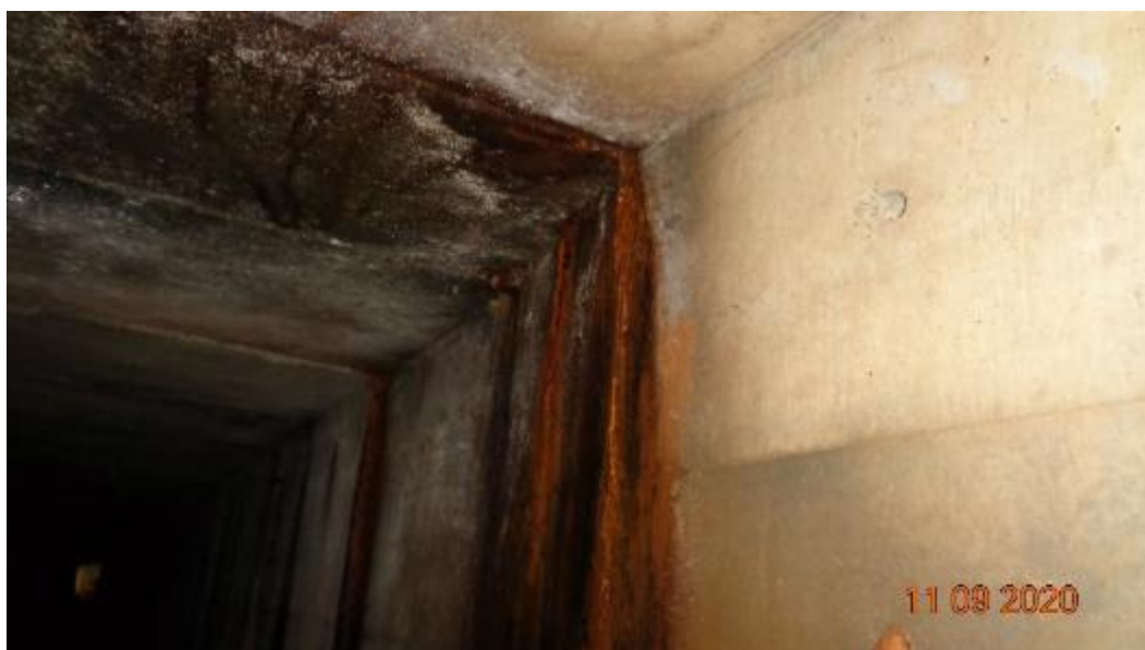
Figura 60 – Juntas com carbonatação e saída material do reservatório (Insp. 2020)
