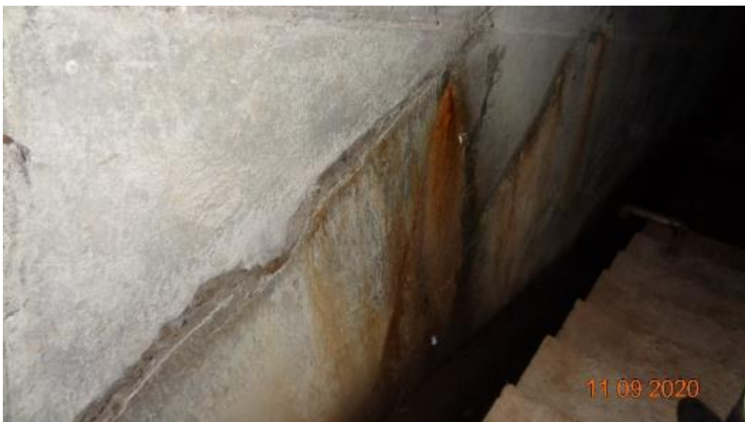
Figura 59 – Pontos com carbonatação e corrosão armadura (Insp. 2020)
