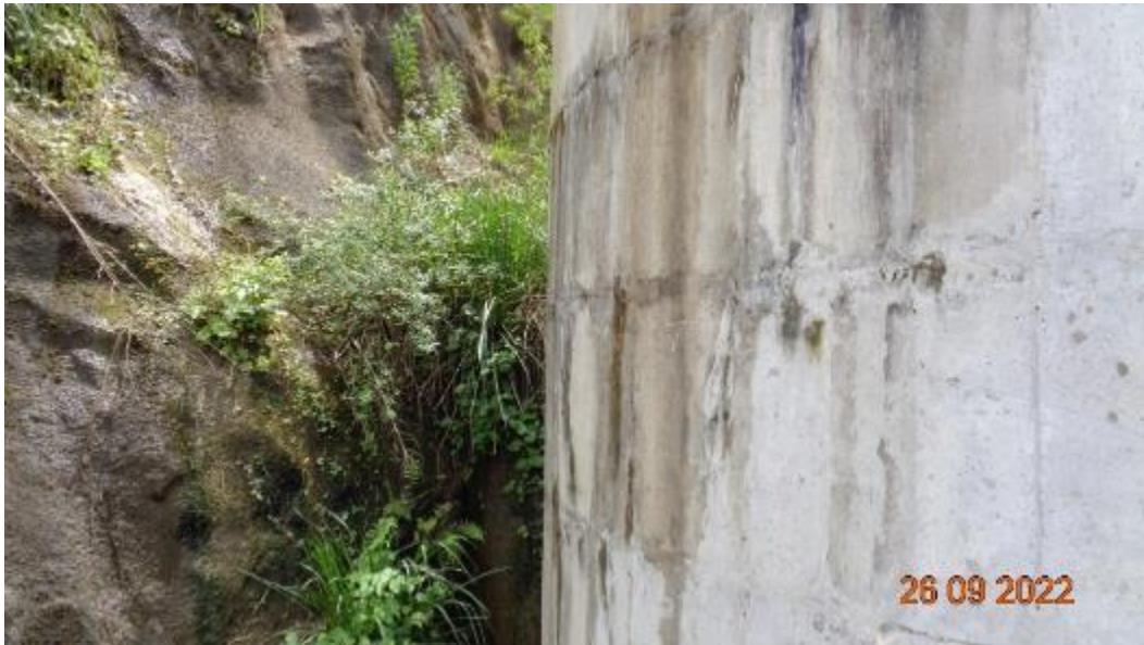
Figura 84 – Percolações naturais da rocha – lateral direita da chaminé
