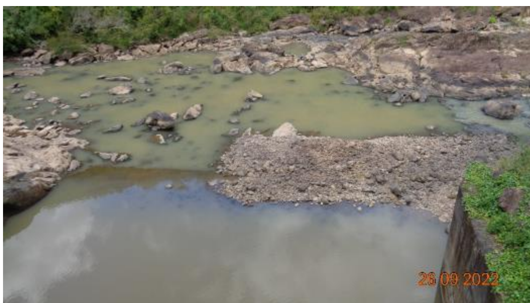
Figura 106 – Barra de material depositado na jusante do canal de fuga
