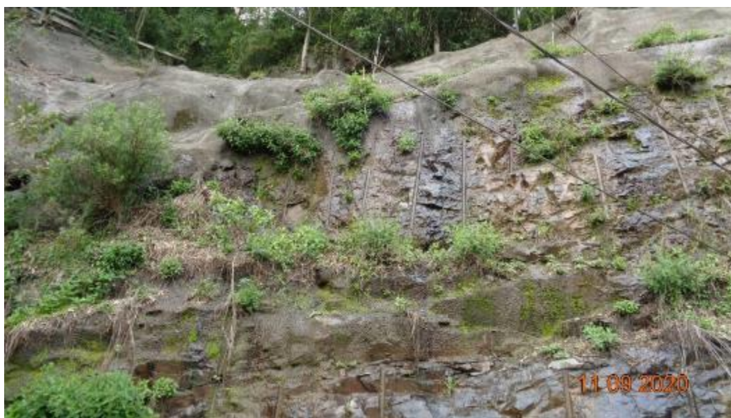
Figura 68 – Retirar vegetação do talude (Inspe. 2020)
