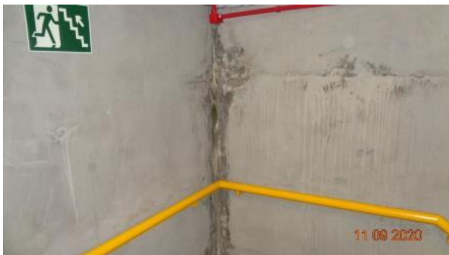
Figura 97 – Ponto de infiltração na escada (Insp. 2020)
