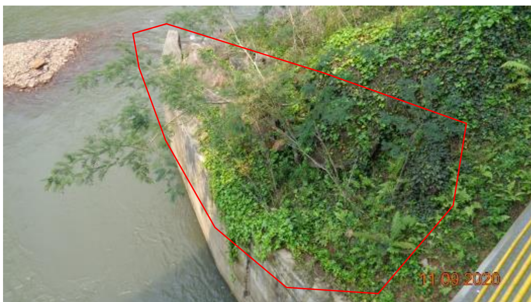
Figura 89 – Necessidade de limpeza da vegetação de maior porte (Insp. 2020)
