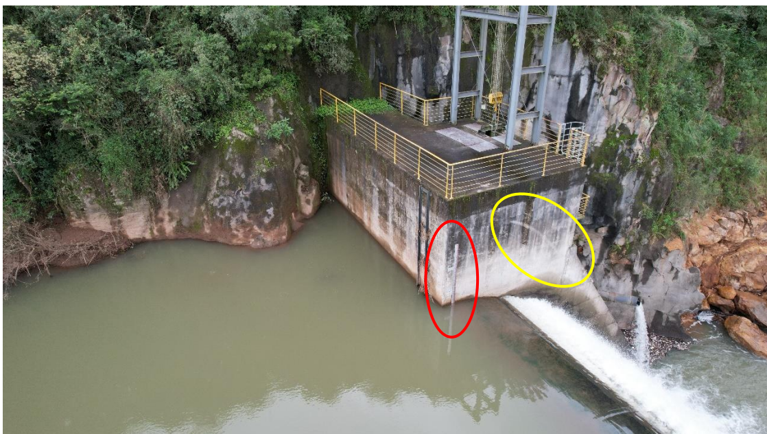
Figura 28 – Régua de nível em boas condições e marca do nível de cheia
