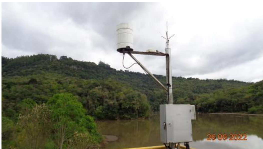
Figura 28 – Estação hidrométrica instalada na Barragem
