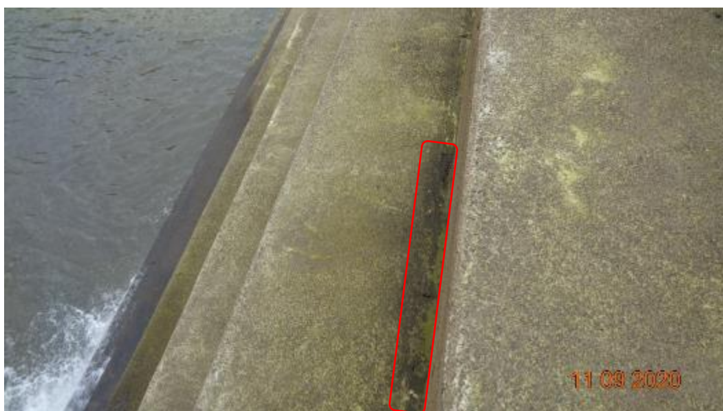
Figura 54 – Bicheiras/Cavitação nos degraus
