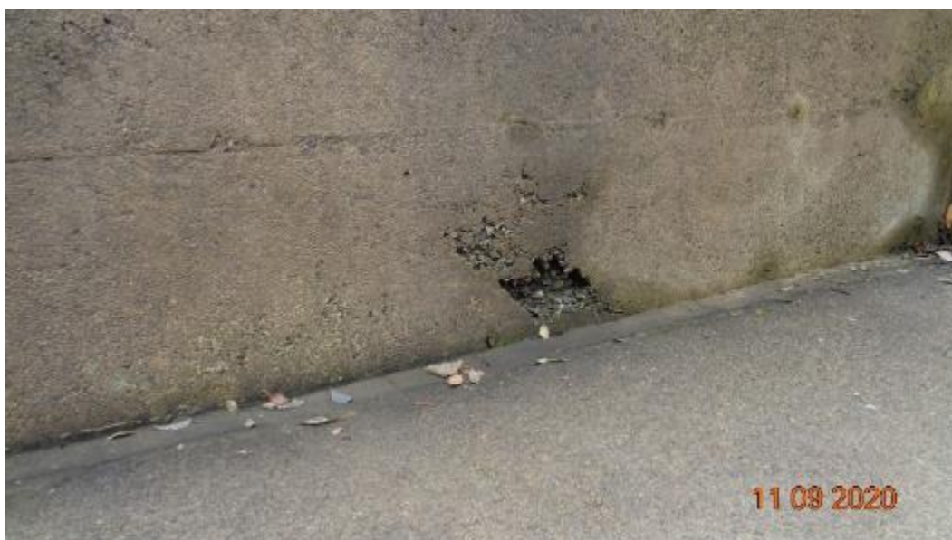
Figura 53 – Bicheiras/Cavitação nos degraus
