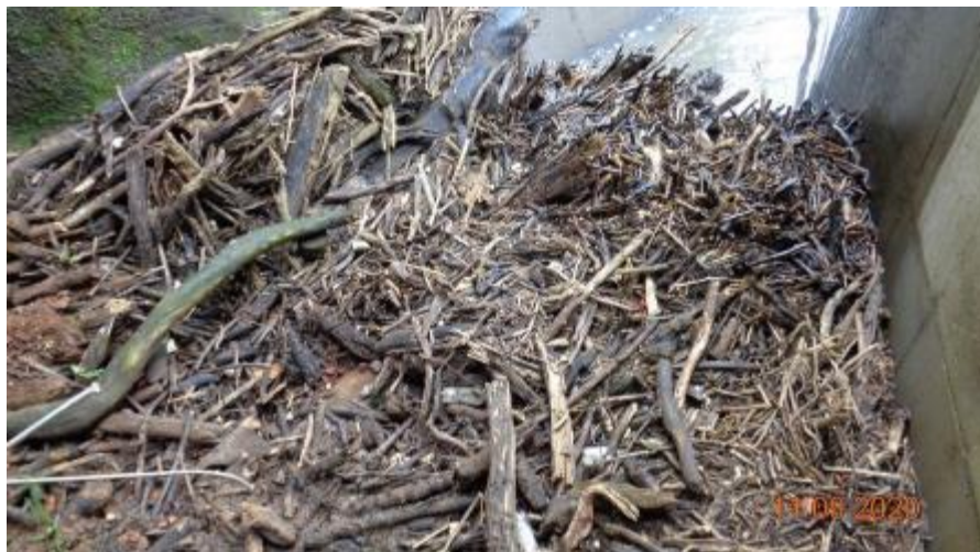
Figura 38 – Material das enchentes acumulado na saída descarga de fundo (Insp. 2020)
