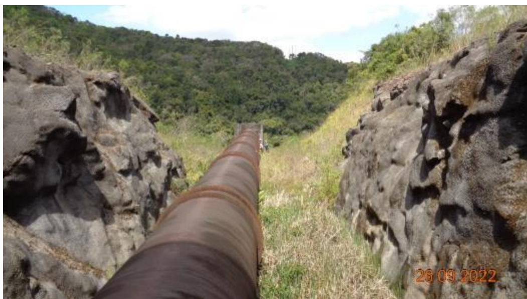
Figura 79 – Conduito forçado em aço
