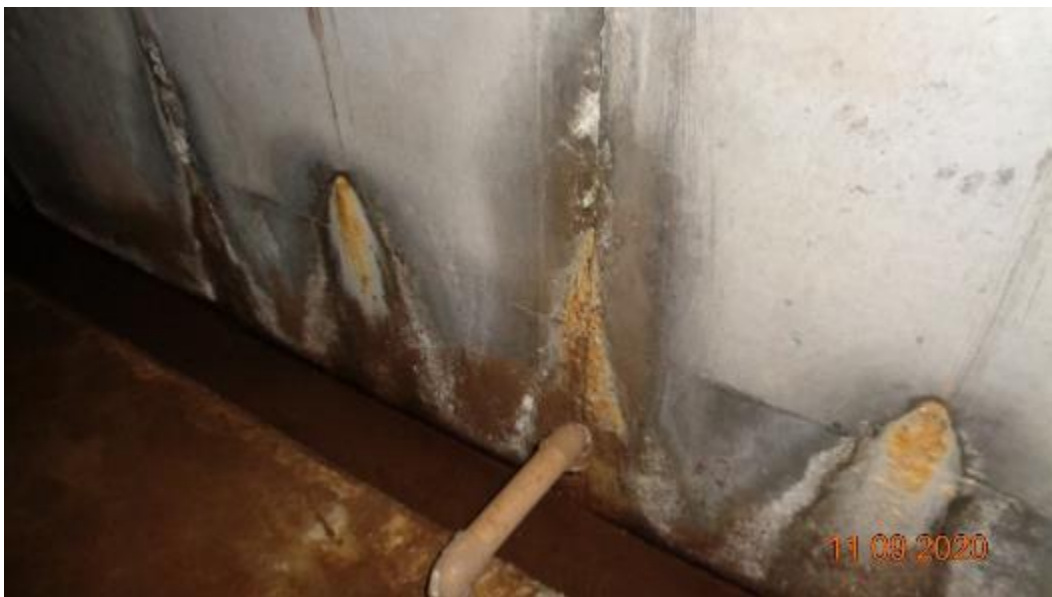
Figura 58 – Pontos com carbonatação (Insp. 2020)
