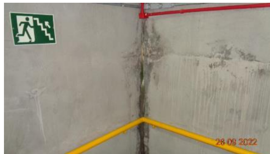
Figura 98 – Ponto de infiltração na escada, sem alterações (Insp. 2022)
