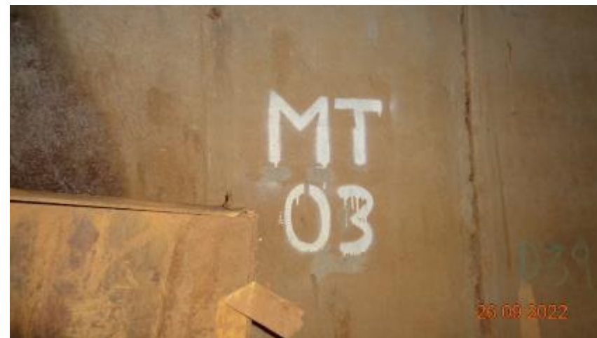
Figura 15 – Melhor Proteção e identificação Medidor Triortogonal de Junta – MT (Insp. 2022)
