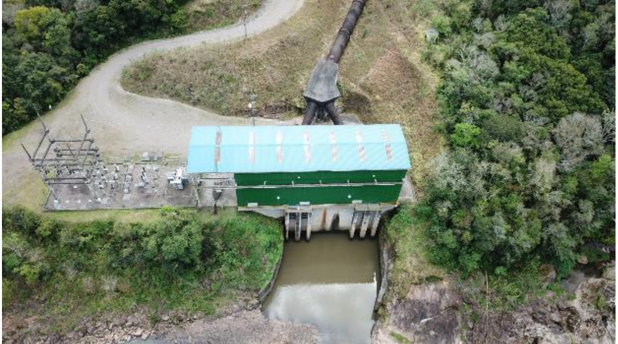
Figura 86 – Pátio da Casa de Força e subestação
