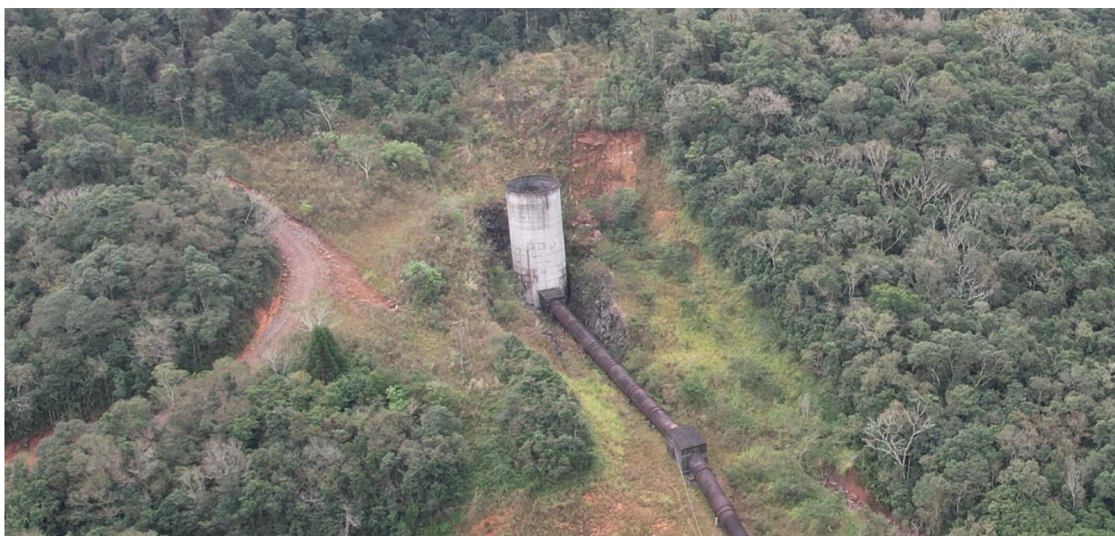
Figura 40 – Chaminé de Equilíbrio (ISE 2024) com destaque ao escorregamento
