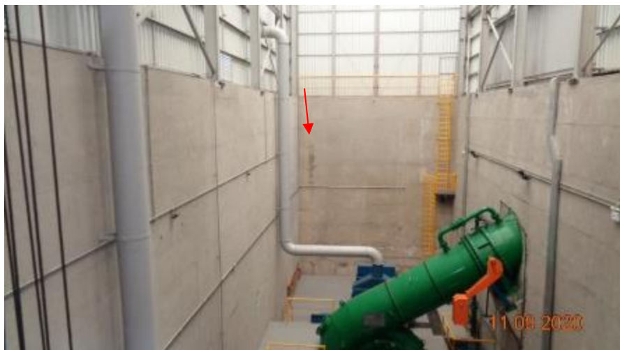
Figura 95 – Ponto de infiltração na parede lateral esquerda (Insp. 2020)
