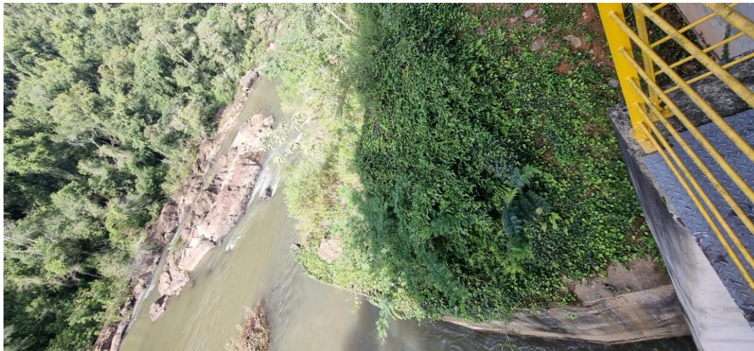
Figura 6 – Necessidade de limpeza da vegetação de maior porte e assoreamentos
