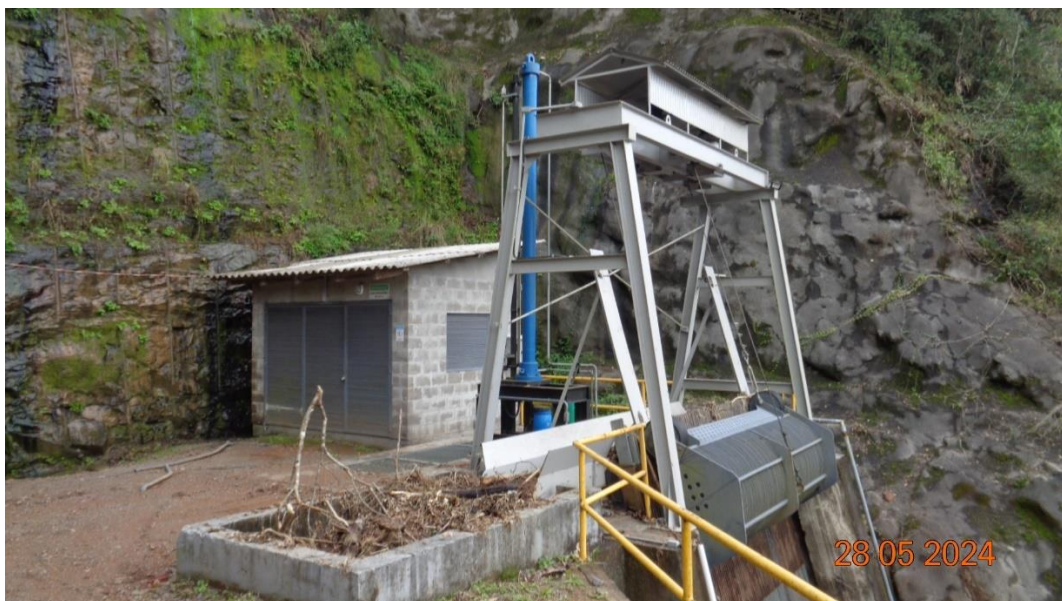
Figura 37 – Sala de máquinas, pistão de movimentação da comporta e estrutura do limpa grades
