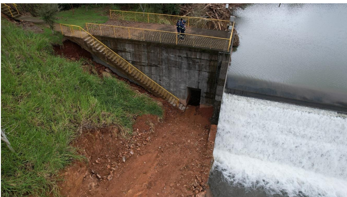
Figura 23 – Estrutura de concreto em bom estado e erosão na escada de acesso
