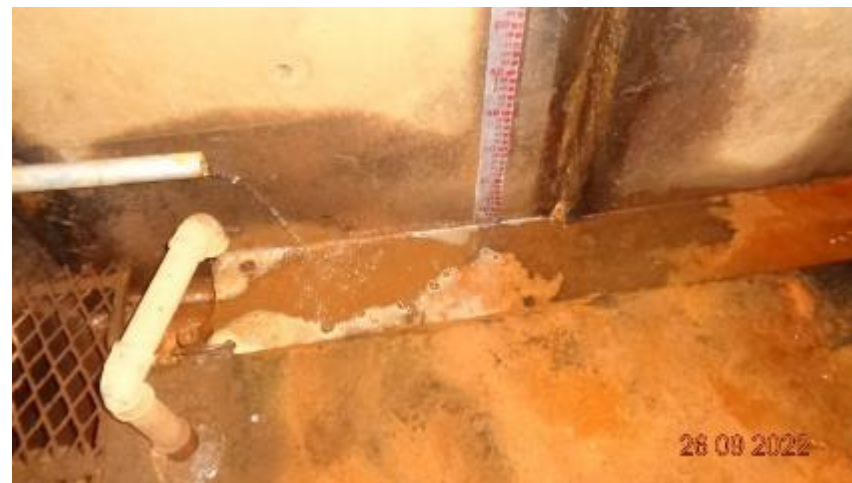
Figura 19 – Medidor de vazão dentro galeria, com identificação e nova régua (Insp. 2022)
