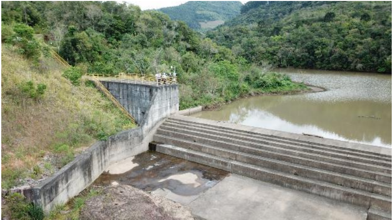
Figura 48 – Infiltrações no vertedouro junto Margem direita
